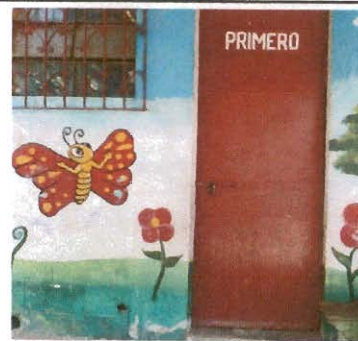
Foto 6: puertas sin chapa modulo I
