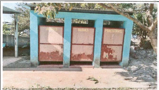
Foto 2: Puertas principales del modulo de los baños en mal estado con corrosión
