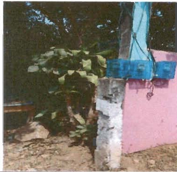
Foto 3: pared perimetral en mal estado lado oeste
