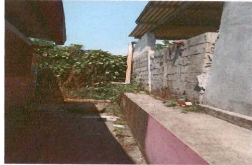
Foto 2: Parte de la pared perimetral a punto de colapsar lado norte
