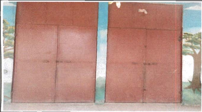
Foto 1: Puertas principales del aula en mal estado con corrosión modulo I
