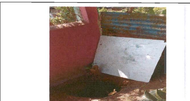
Foto 6: drenaje colapsado sin servicio
