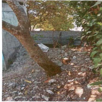
Foto 1: pared perimetral de lamina en mal estado lado oeste
