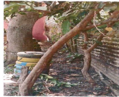
Foto 4: laminas que circulan la escuela en mal estado
